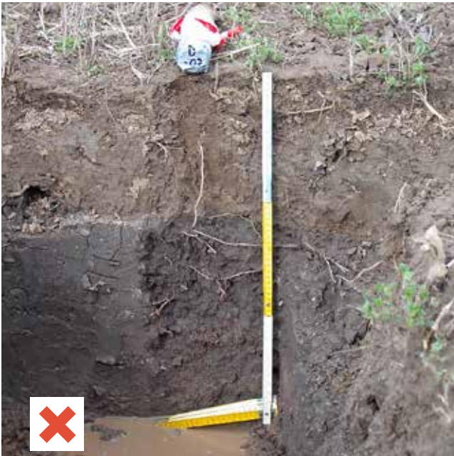
Schlechte Durchwurzelung infolge fehlender Verzahnung des aufgetragenen Oberbodens mit dem anstehenden und verdichteten Unterboden.
