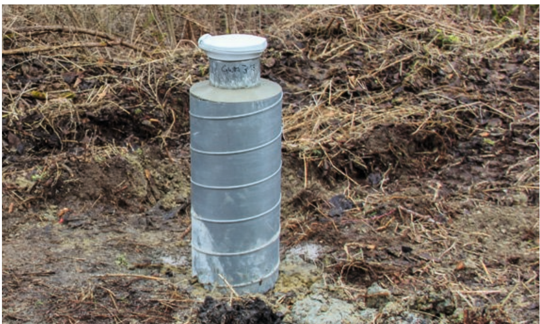
Peilrohr einer Grundwassermessstelle in Baden-Württemberg
